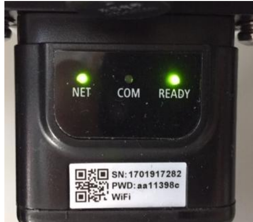
Abbildung 65 - Unregelmäßiger Kommunikationsstatus zwischen Inverter und Platine
