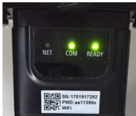
Abbildung 66 – Unregelmäßiger Kommunikationsstatus zwischen Platine und Remote server
